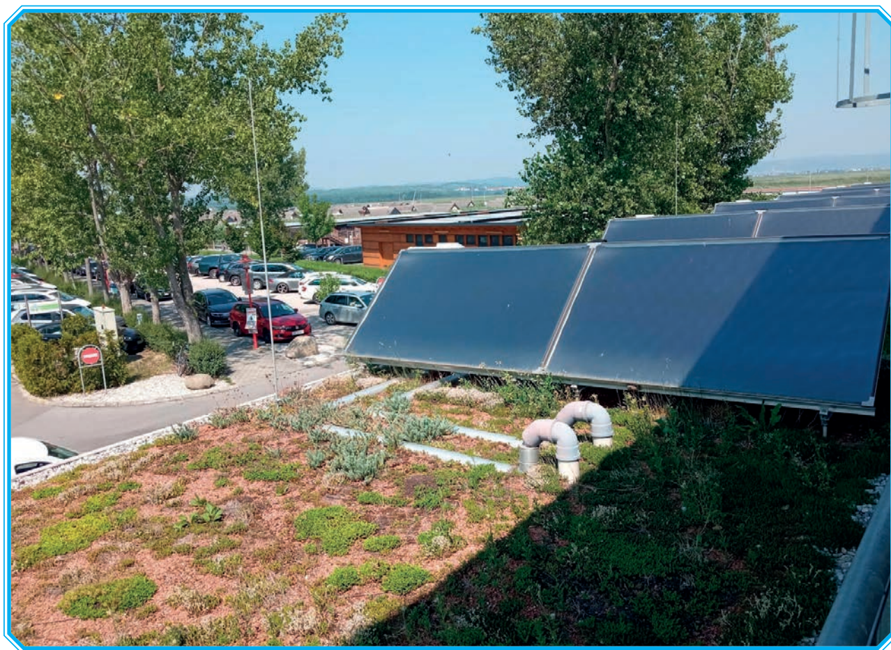
Obrázok 21: Využitie fotovoltaických panelov na vegetačnej streche
